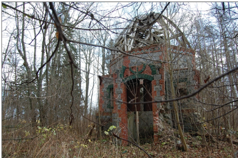
A. Kościenica, obecny stan zachowania mauzoleum. Fot. Jadwiga Kowalczyk-Kontowska, 2009
